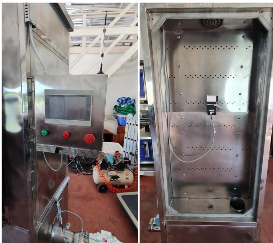
รูปที่ 4.18 ตำแหน่งติดตั้งเซ็นเซอร์วัดก๊าซโอโซนภายในและภายนอกตูรมก๊าซ
